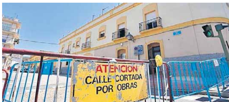
La plaza del Carbón, cortada por los hundimientos en la calzada.
