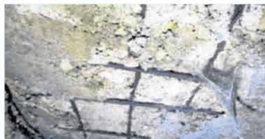
En alguna zona el hormigón se encuentra deteriorado.
